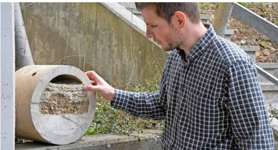
Zum Teil sind die Entwässerungsleitungen extrem verkalkt. Das war auch bei diesem Rohrstück der Fall, das 2016 ersetzt wurde. Es steht als Erinnerungstück vor dem Eingang der Bauverwaltung. Archivbild: vf
