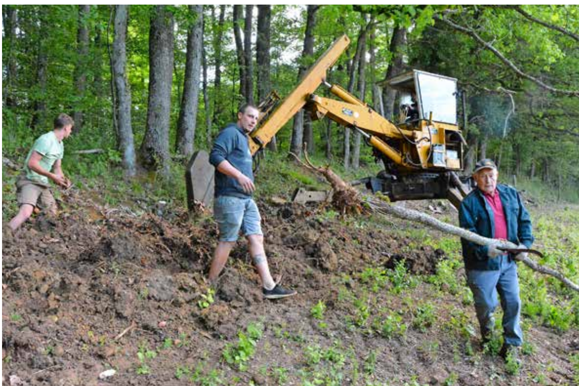
Walter Bühler reisst mit seinem Schreitbagger den Untergrund auf. Derweil lesen Moritz Krebs (von links), Yannik Stampfli und Kurt Ehrat aus der Erde Wurzeln heraus und tragen herabgefallene Äste weg. Bild: vf
